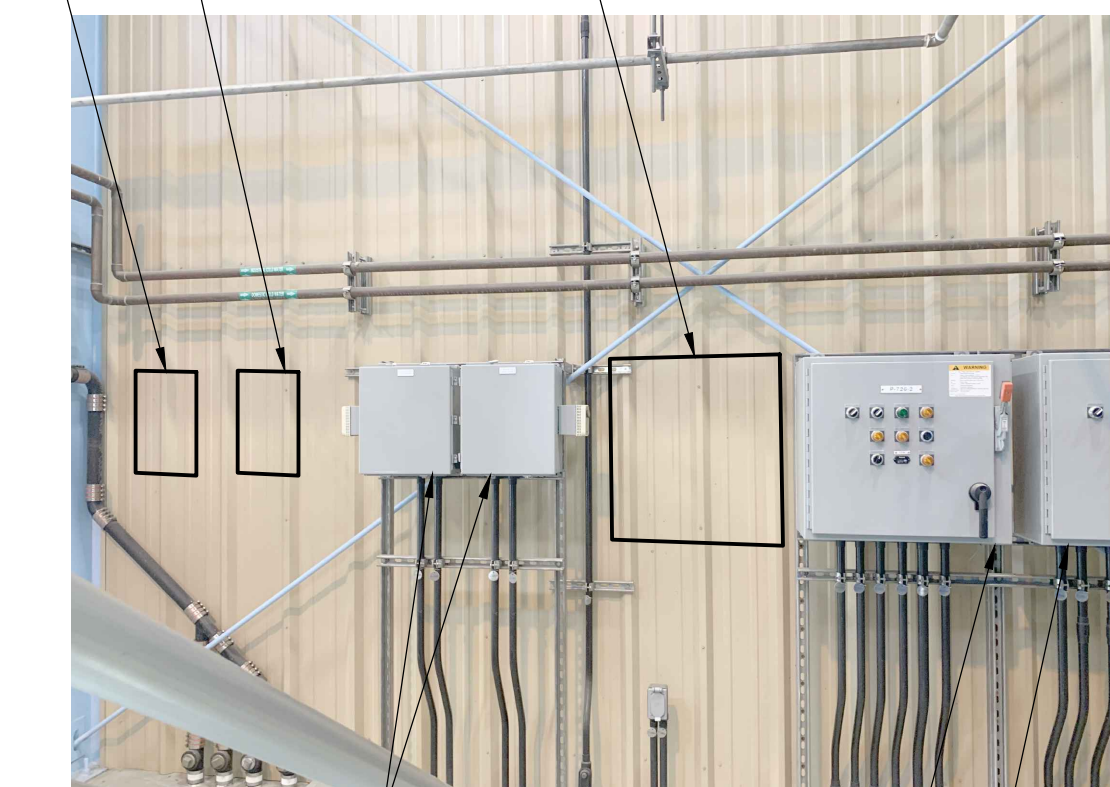
LEFT: FAN T-STAT CP RIGHT: P-726-1 AND P-726-2 VFD
